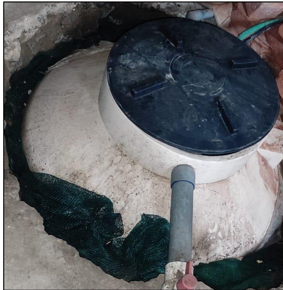
Figura 30. Tanque de PVC.
